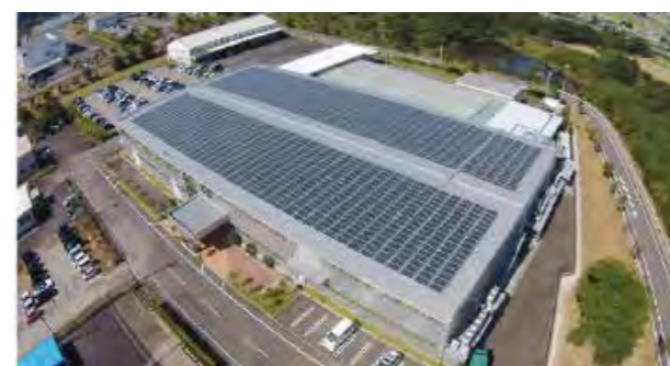
▲ ソディック エフ・ティ宮崎事業所 社屋屋上の太陽光発電システム
